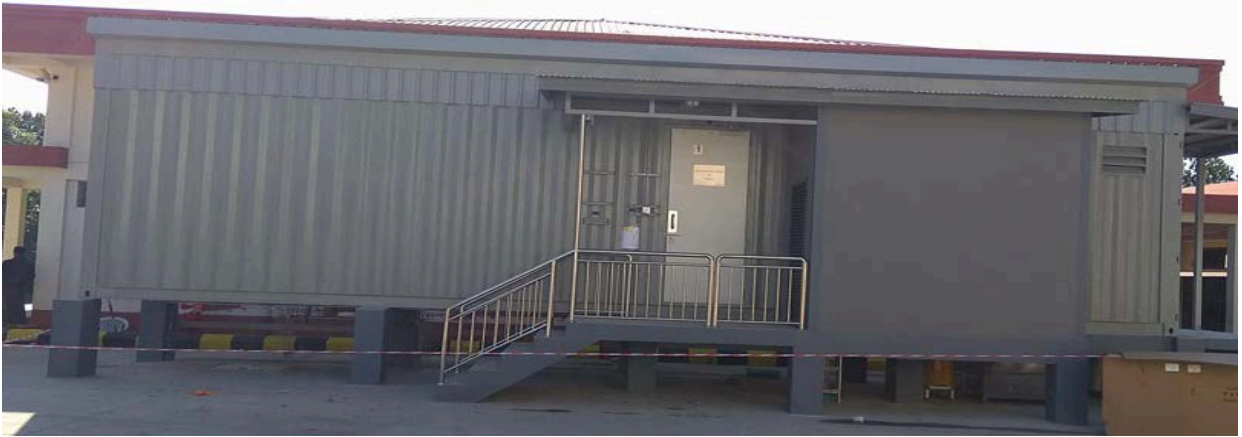
Mini Data Center ဝယ်ယူတည်ဆောက်မှု
